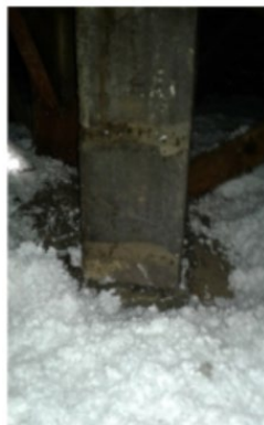
Exemple d'absence de coffrage autour du conduit de fumée
