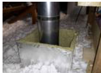
Exemple de coffrage avec épaisseur d'isolant insuffisante
